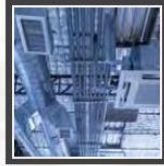
ISITMA, HAVALANDIRMA, İKLİMLENDİRME (HVAC) SİSTEMLERİ
